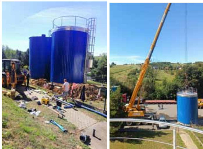
Modernizacja stacji uzdatniania wody w Dynowie – fot. ze zbiorów Urzędu Miejskiego w Dynowie
